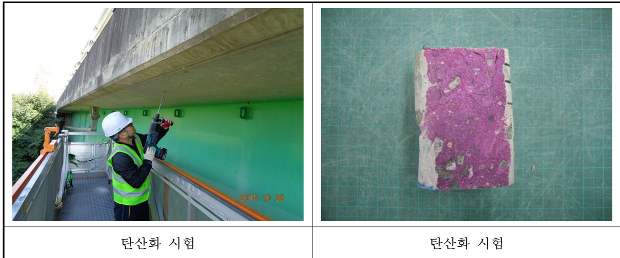
〈사진 3.23〉 탄산화 현황
